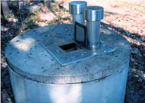
Kaivon kannessa on suojahatulliset tuuletusputket sekä pieni näytteenottoluukku. Kuva: Toivo Lapinlampi
