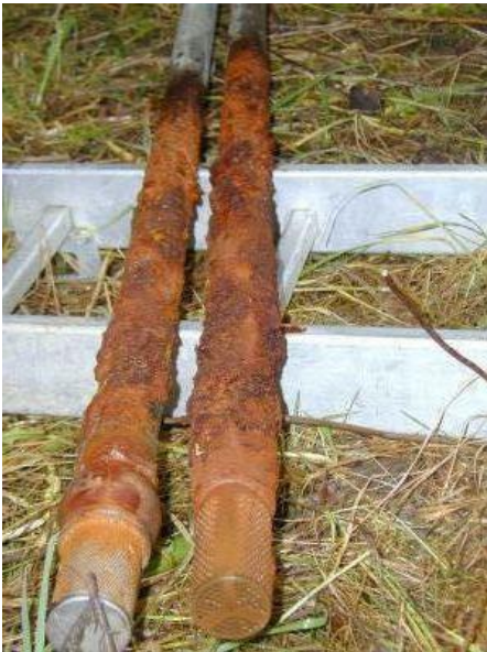
Surt och mjukt brunnsvatten gör att metallrören i brunnen rosta. Foto: Vesikaivohuolto VIPE Oy
